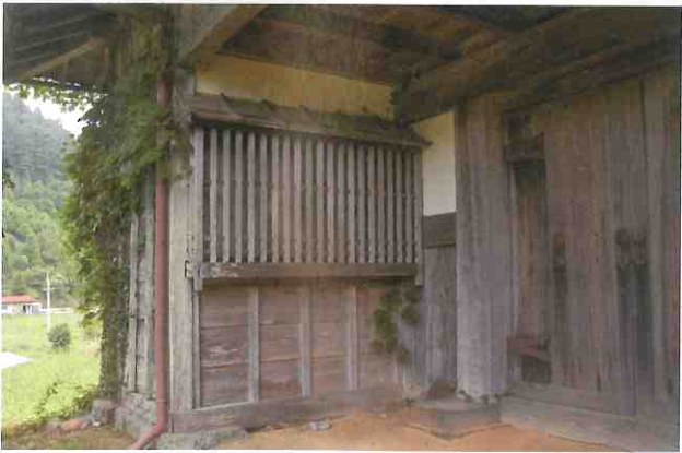
長屋門や土蔵などが残る富貴村大庄屋名迫家 主屋は平成10年9月の台風で倒壊したそうです（近所の方談）。在りし日の主屋には大玄関、中玄関、中段の間、上段の間などがあり、座敷の回りには広い縁が設けられていました。玄関の登り口の部屋には大床があり、ここには槍や十手、コトジなどといった召し捕り用の道具が順序よく掛け並べられていたということです。これは名迫家が、今で言う警察署の役目をも担っていたからで、実際に裁決する場合は、上段の間に高野山の年預代が坐り、中段の間に胡乱方と呼ばれた裁判という検事である名迫氏、控えの間には村役人、縁側には取方が控え、罪人は中庭に引き出されたそうです。
