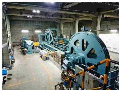
前号で特集した巻上機 まきあげき （ケーブルカーの動力部分）も一新されました。
