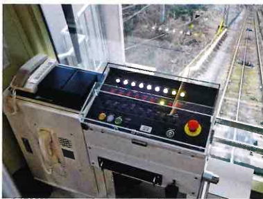
車内、乗務員室の機械類は日本ケーブル社製です。
