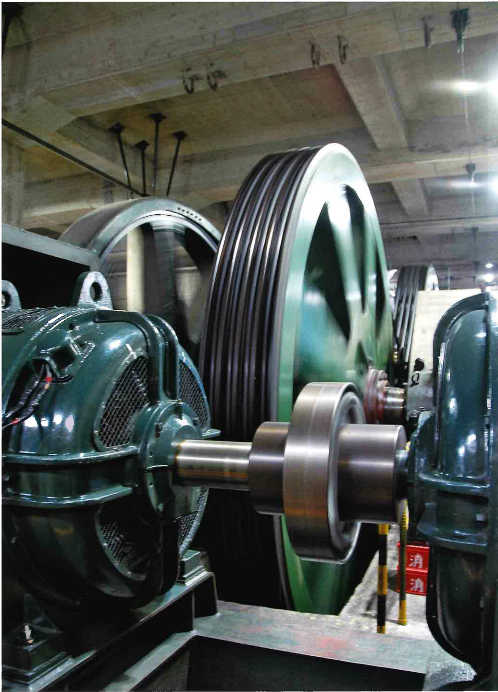
高野山駅ケーブル巻上機 右の緑の車輪が主索輪、左の車輪はモーターの動力を主索輪に伝えるギア（歯車）です。（詳細は67ページ）
