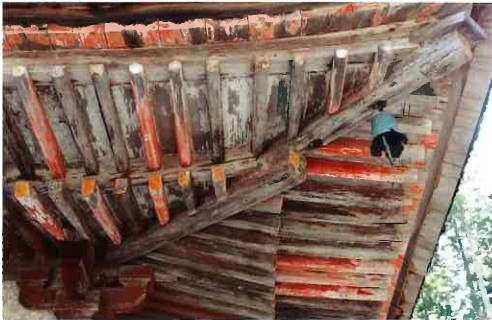
下層の軒の詳細 垂木の配置をよく見ると、その間隔はかなりバラバラだ。技術的には未熟ともいえるが、苦勞の跡が伝わってくる。
