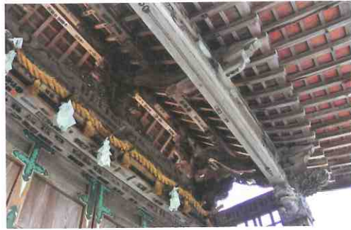
軒の見上げ 大きな材を豪快に組み上げて屋根を受ける。大きく湾曲した垂木はこの門独特の形状である。
