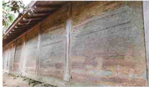
西側の「築地堀」 土を叩き締めて築いた堀。表面には5cm程の厚さで積み重ねられた土の層が筋状に残る。堀の表面は黒くなっていて、土を積む時に用いた桧板が剥がれやすいように板に塗った油の痕跡らしい。
