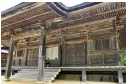
正面側の詳細 向拝の虹梁や、獺の木鼻、龍の中備え彫刻、臺段の彫刻、桁下の波彫刻の支輪板など細部に注目すると、江戸末建築の特色が満載である。
