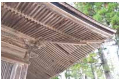
軒廻りの詳細 地垂木と飛檐垂木の2段で構成される軒廻りは、降雨から建物を護るために、時代と共に外に張り出すようになる。大会堂の軒は当時考えられた最大の軒の出となっている。
