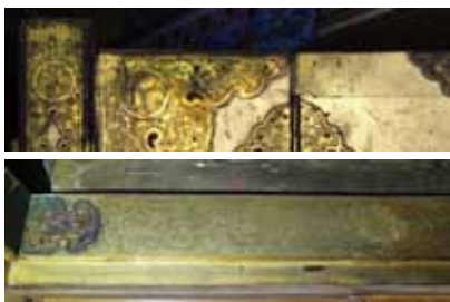
内外陣板唐戸の詳細 扉は全面が金箔押しで、豪華な金色の金具で飾られている。金具には三つ葉葵紋が彫金され、東照宮の遺構であることを確信させる意匠となっている。
